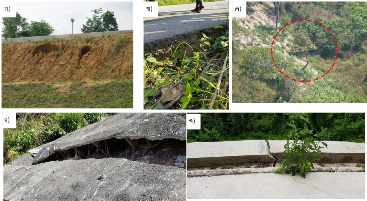
รูปที่ 2.1 ลักษณะสำคัญที่ควรสังเกตระหว่างการเดินสำรวจสภาพพื้นที่ ก) ร่องรอยการกัดเซาะ ข) การยุบตัวของดิน ค) ต้นไม้ที่คดงอไปมาแสดงถึงการเคลื่อนตัวของมวลดิน ง) การแตกร้าวและโพรงใต้ Shotcrete จ) รอยแตกร้าวบนโครงสร้าง
