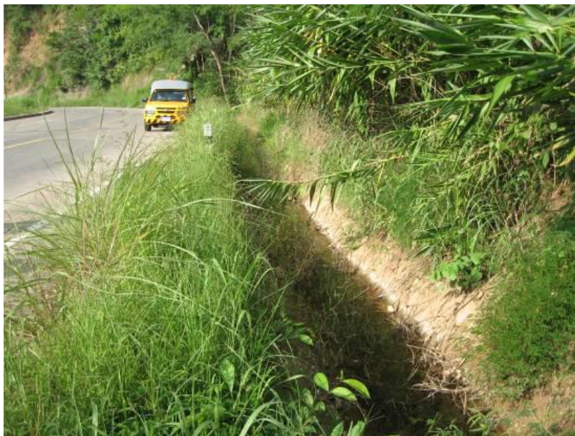
รูปที่ 6.2 ตัวอย่างรางระบายน้ำที่ขาดการบำรุงรักษา ที่มา: กรมทางหลวง (2554)
