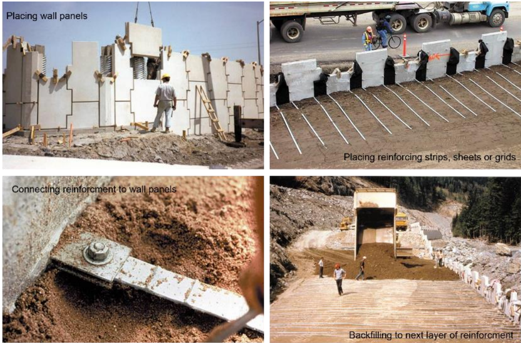
รูปที่ 5.10 ขั้นตอนการก่อสร้างกำแพงเสริมกำลัง ที่มา: LaRiMiT (2022)
