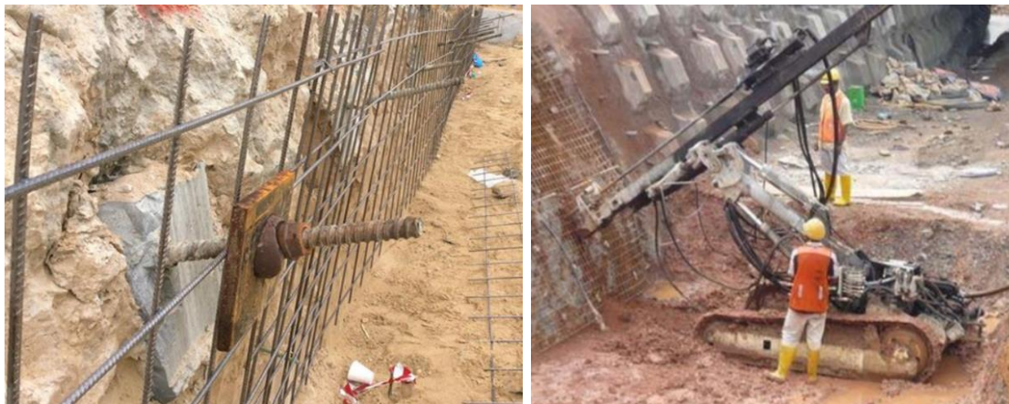
รูปที่ 5.17 แสดงลักษณะการก่อสร้างกำแพง Soil Anchor
