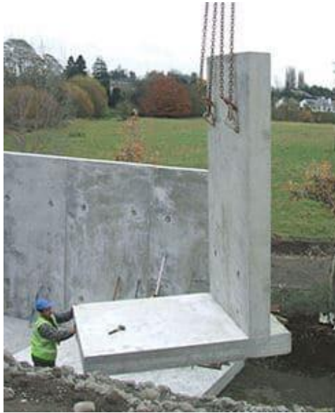
รูปที่ 5.1 กำแพงกันดินแบบ Cantilever ที่มา: The Constructor (2022)
