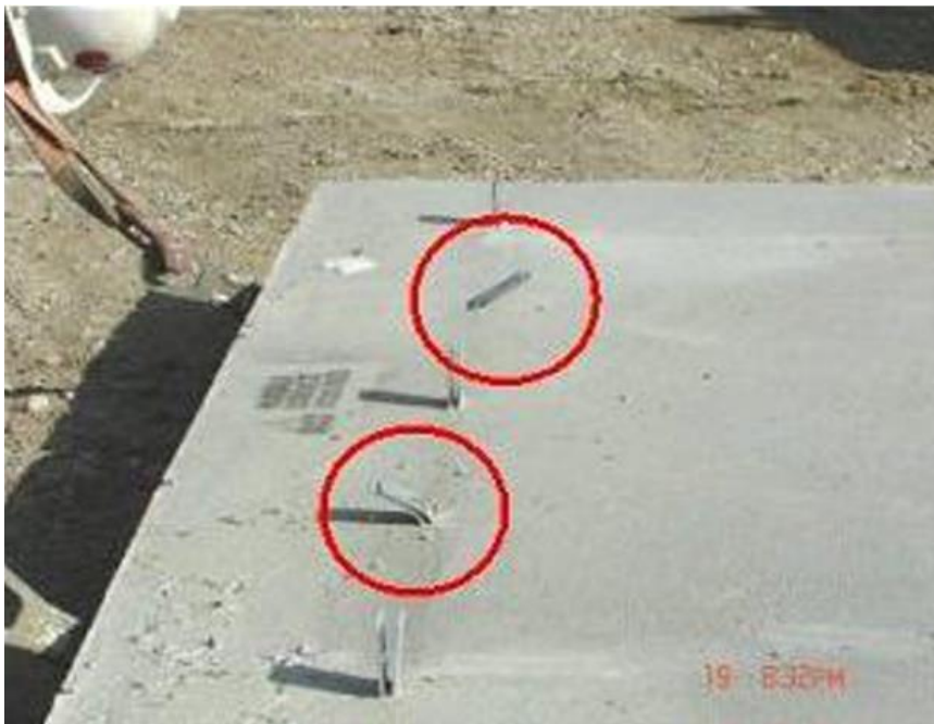
รูปที่ 5.9 ตัวอย่างความเสียหายของแผ่นปิดหน้า ที่มา: FDOT State Construction Office (2020)
