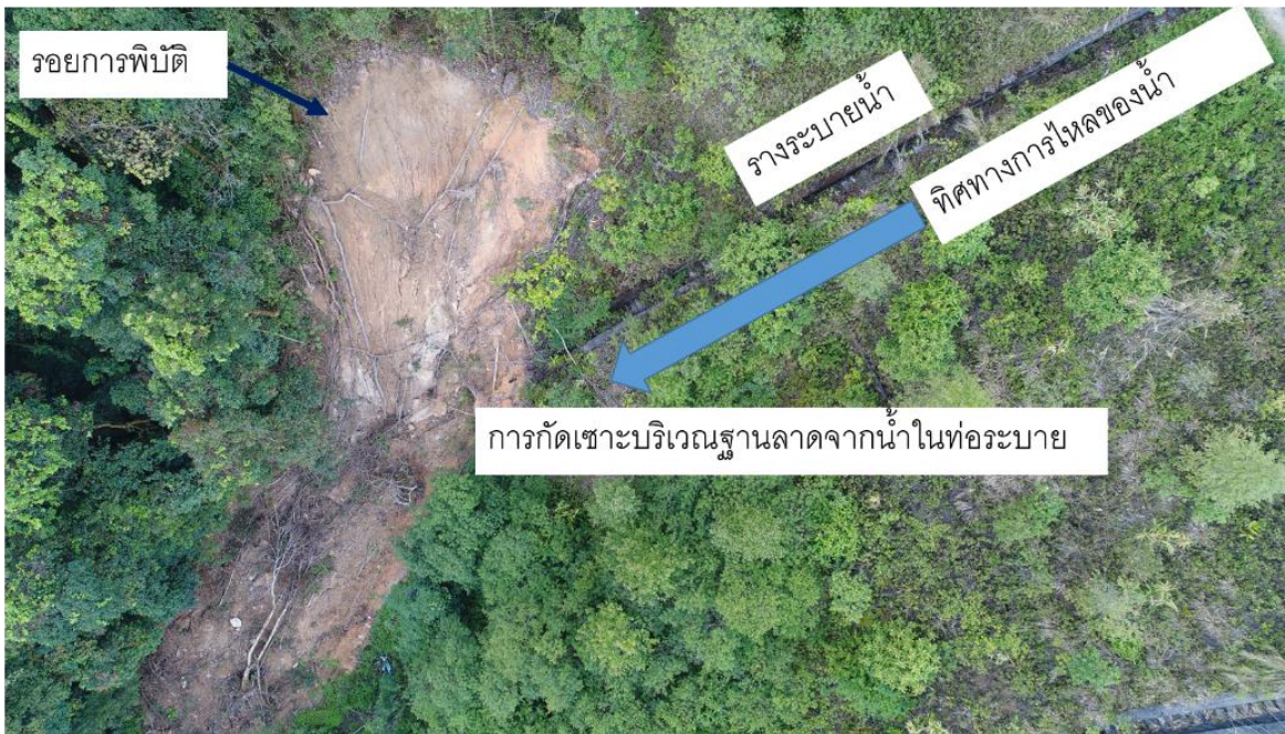
รูปที่ 1.2 ตัวอย่างการพังทลายเนื่องจากน้ำกัดเซาะบริเวณปลายเชิงลาดคันทาง (Erosion at Toe Slope) จากน้ำในรางระบายน้ำ (ภาพด้านบน Top View) ทางหลวงหมายเลข 1009 กม. 42 จังหวัดเชียงใหม่ ถ่ายเมื่อปี พ.ศ. 2565
