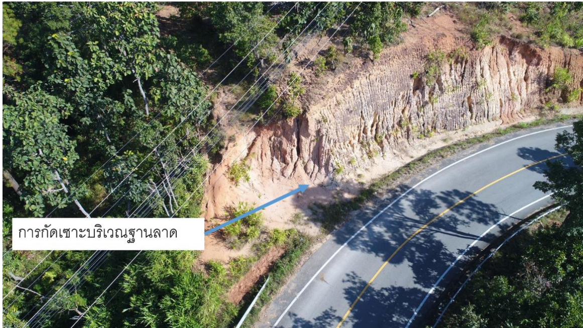
รูปที่ 1.3 ตัวอย่างการพังทลายเนื่องจากน้ำกัดเซาะบริเวณปลายลาดเหนือคันทาง (Toe Erosion of Back Slope) ทางหลวงหมายเลข 1192 ช่วง กม 11+500 จังหวัดเชียงใหม่ ถ่ายเมื่อปี พ.ศ. 2565
