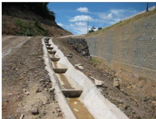
รูปที่ 6.11 Stepped Drain Chute ที่มา: วรัช และคณะ (2556)
